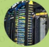
光纤通信机房
