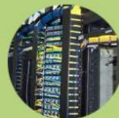
光纤通信机房
