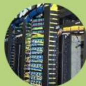
光纤通信机房
