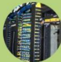
光纤通信机房
