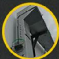
电缆桥架接地
